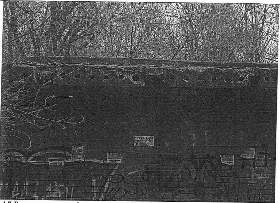
Рис. 4.7 Размораживание бетона плит покрытия. Нарушение кровельного покрытия.
