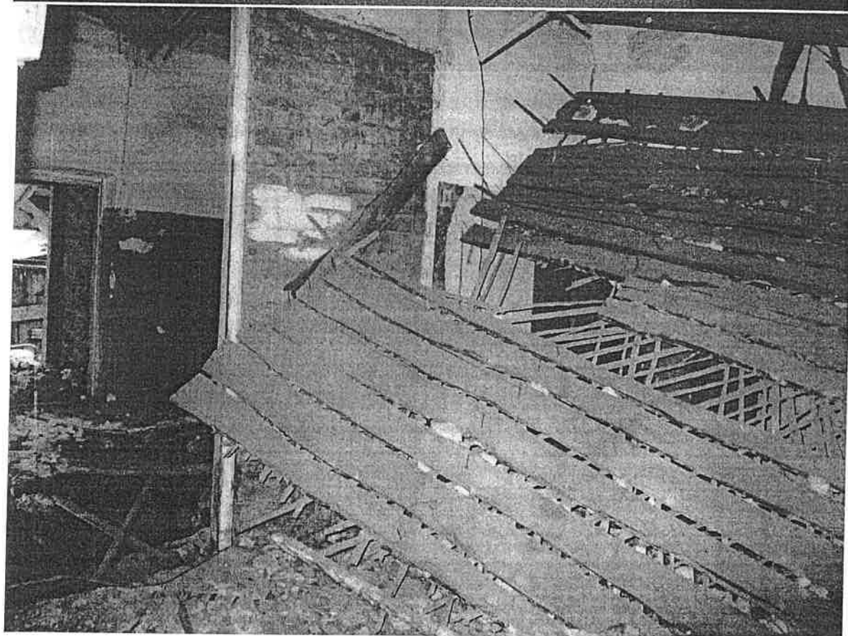
Рис. 4.9 Обрушение конструкций чердачного перекрытия.
