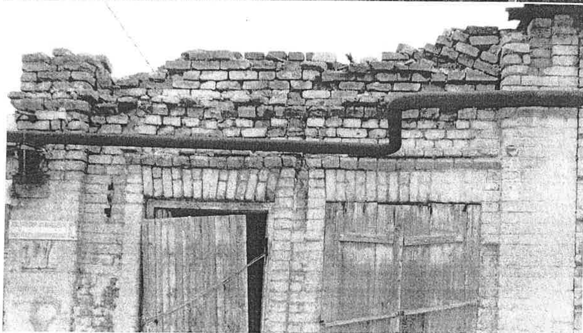
Рис. 4.6 Разрушение кирпичной кладки стен.
