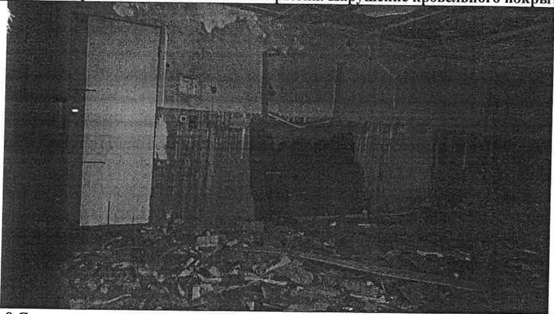
Рис. 4.8 Состояние внутреннего помещения здания. Обвал штукатурки стен и покрытия, следы систематического замачивания стен, разрушение покрытия пола и захламление мусором.
