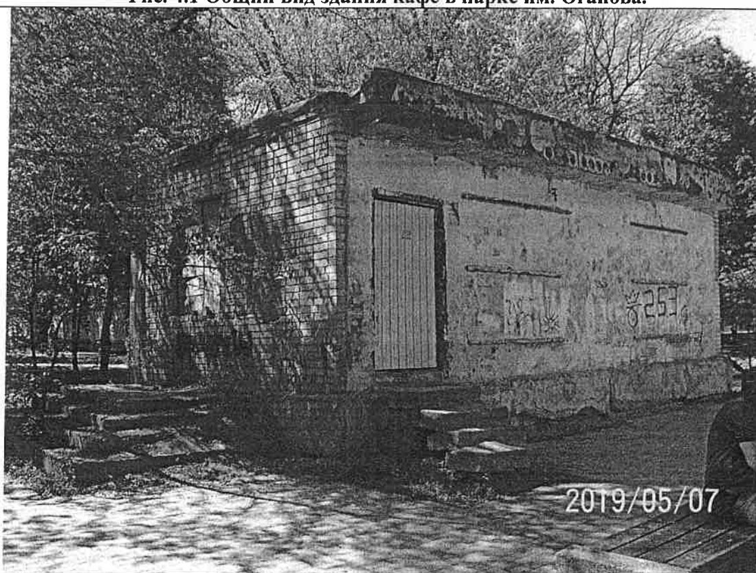
Рис. 4.2 Фасад здания кафе с восточной стороны. Аварийное состояние ступеней. Замачивание конструкций покрытия.
